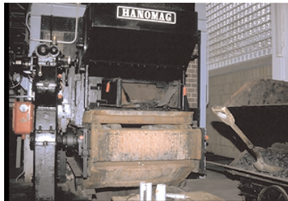
Kesselhinterende mit Wanderrost und Vorratstrichter
